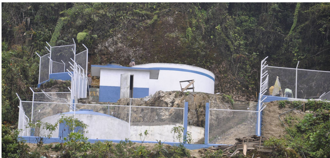
Fotografía 5.4: Sistema de agua de la ciudad de Paquisha.
